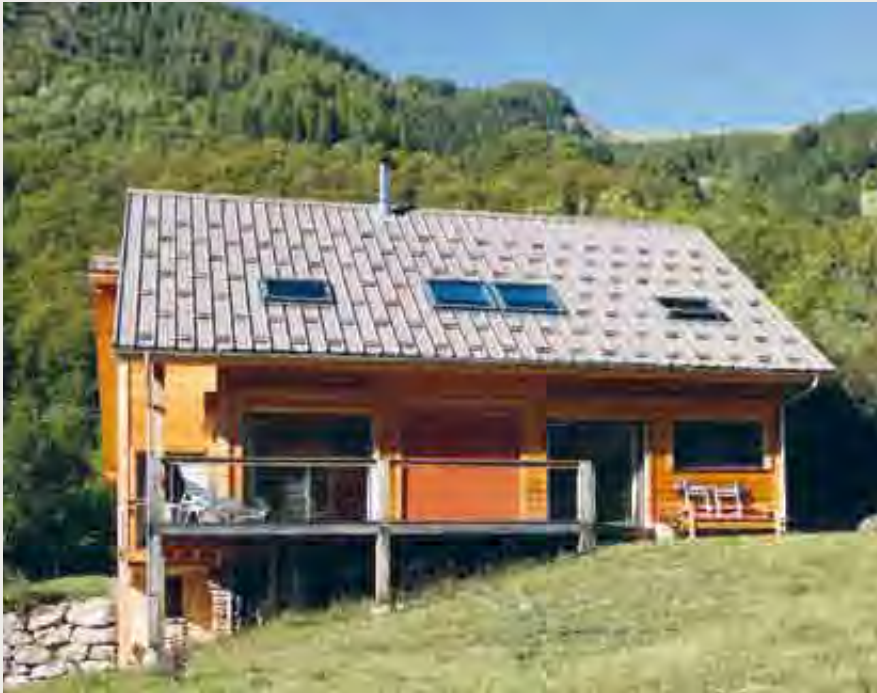
La Roche-des-Arnauds : maison en construction à ossature bois intégrant les principes du bioclimatisme : compacité et façades vitrées bien exposées
