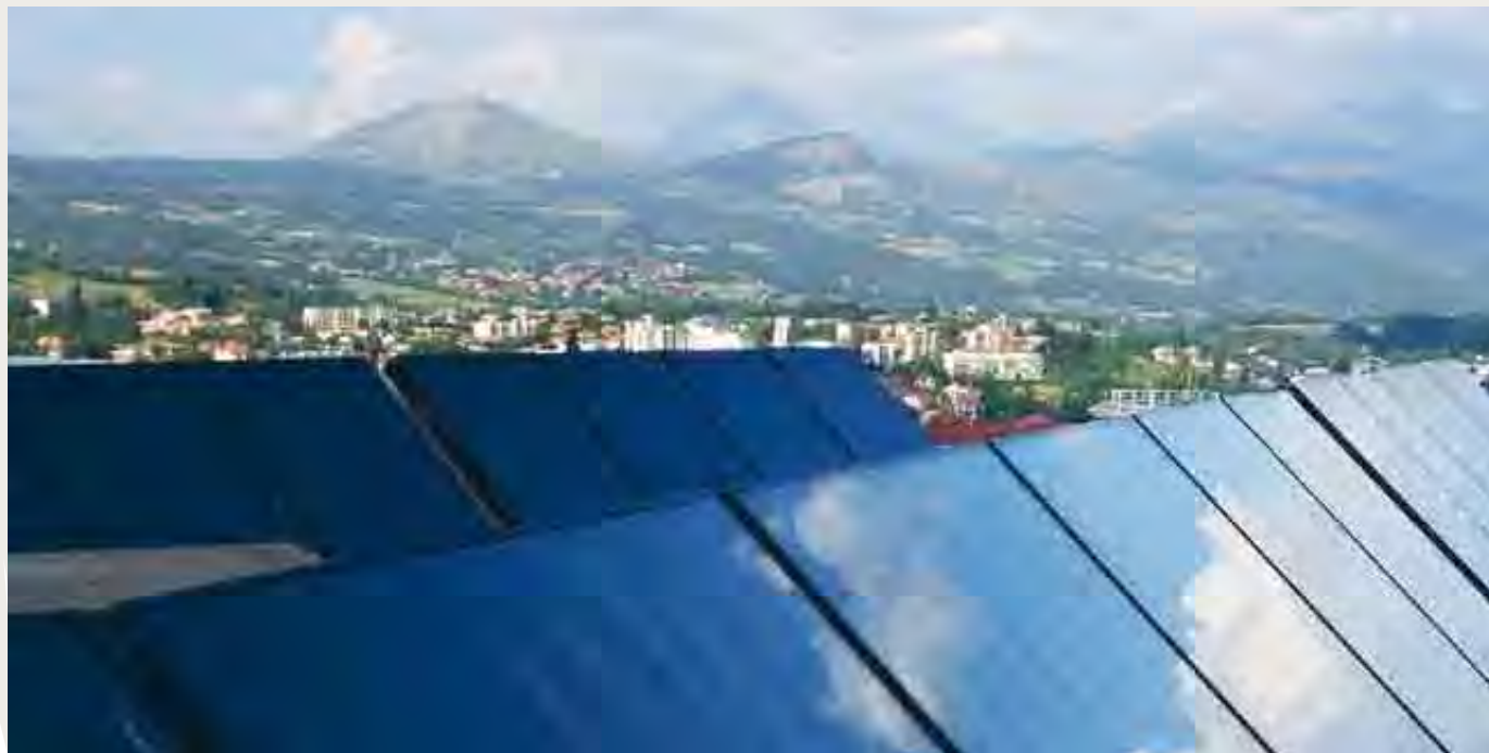
Gap : installation solaire sur les toitures d'une copropriété
